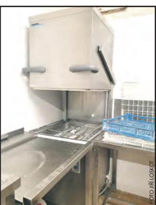
Nově instalovaná myčka nádobí.
